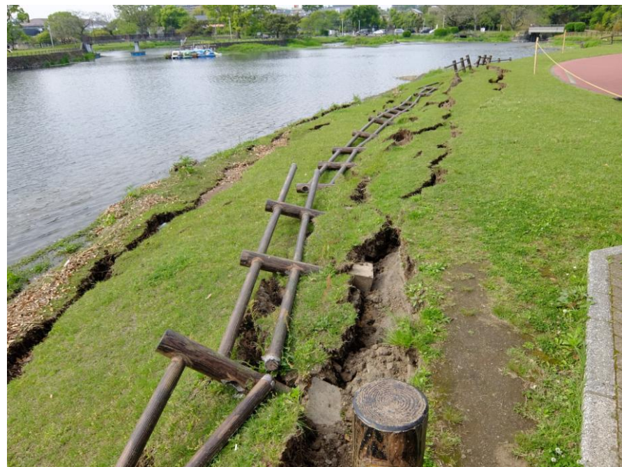
水際部の地割れ、沈下
