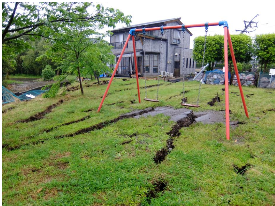
敷地全体の地割れ、滑り(惣領竹之下公園)
